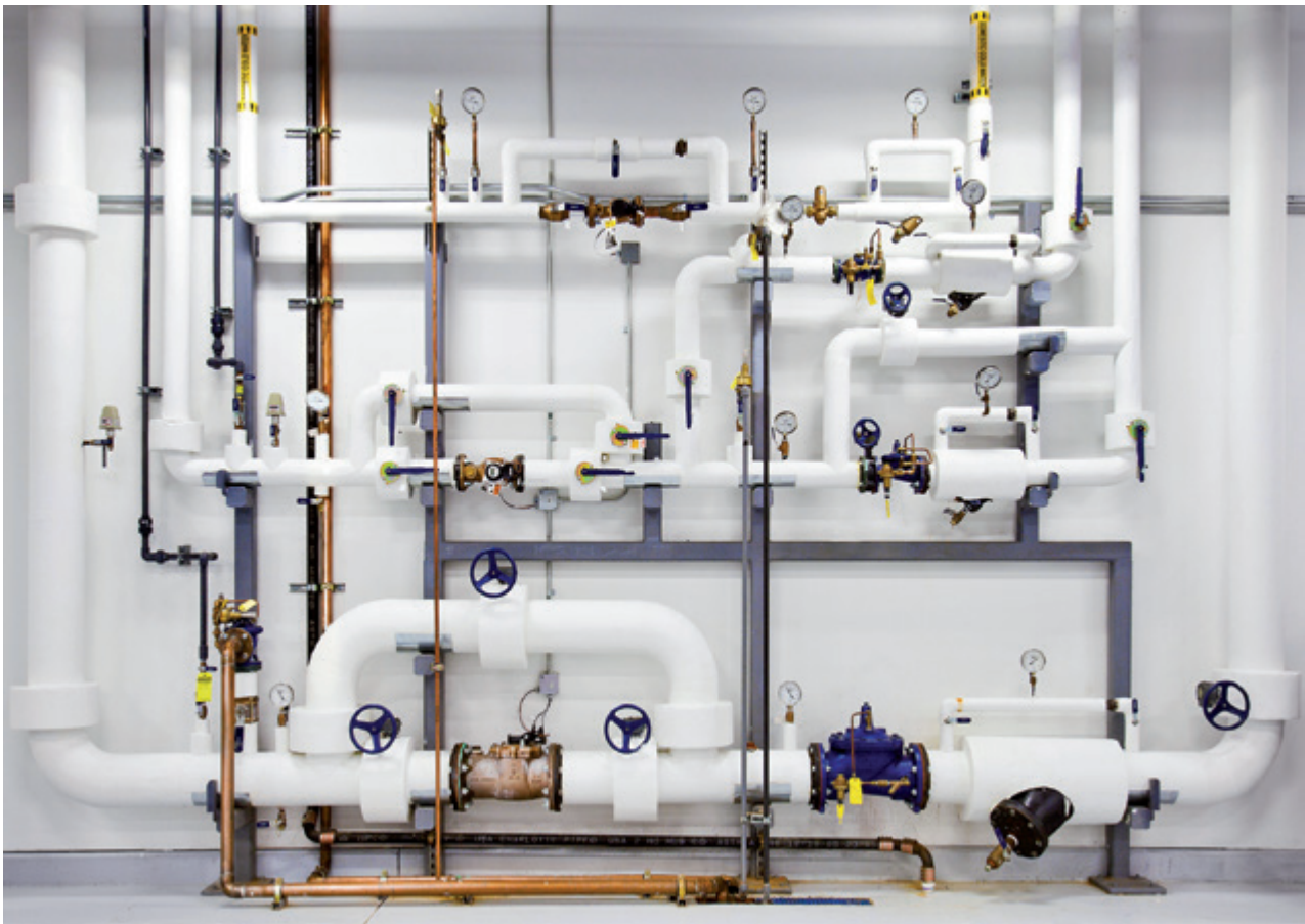
Google-Datenzentrum in Douglas County, Georgia. Leitungen wie diese sind für den Fall eines Feuers mit Hochdruckwasser gefüllt. © Connie Zhou
